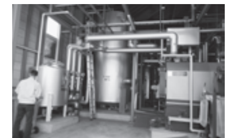
桜ヶ池クアガーデン 温水プール供給用ペレットボイラー(300kW×2基)
