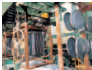
小形変圧器の塗装工程
